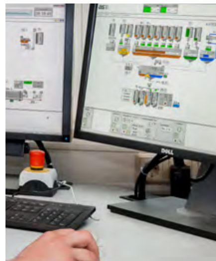
Интеграция оборудования в имеющуюся систему управления не представляет сложности.
